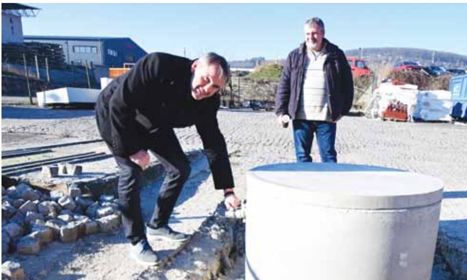
Vítězslav Votruba (vlevo) s místostarostou Petřem Panašem u nové studny v areálu Technických služeb města. Ta příspěvkové organizaci zajistí soběstačnost při čerpání vody. Foto: Radim Tuček
